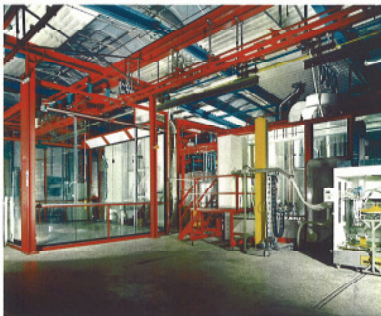
Pulverlackieranlage mit vorgeschalteter RÖSLER Strahlanlage.
